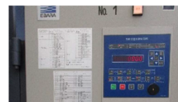
環境制御盤の導入
