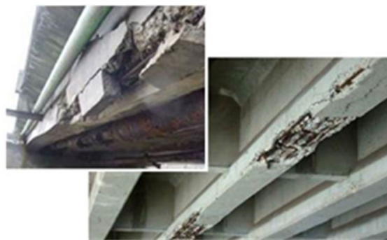
健全度Ⅳ：長野県点検要領より
