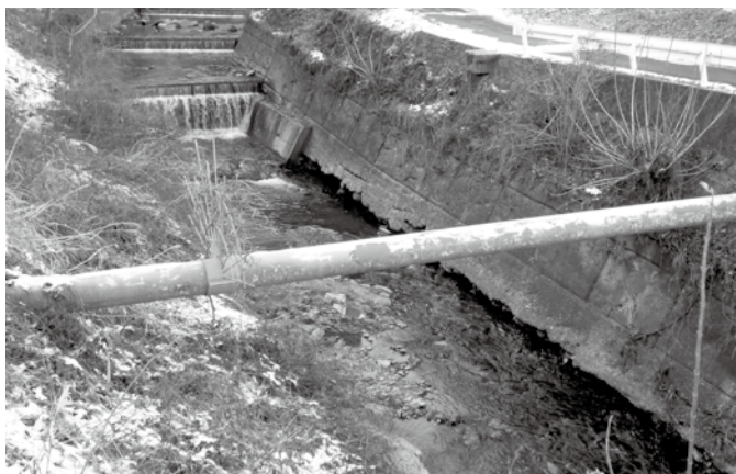
台風19号による被災カ所 (砂防河川 宮沢川左岸)
