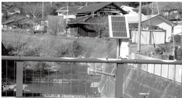
青木橋(田沢川)に 設置されている水位計
