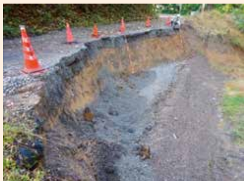
道路が崩落。落差は約2m。
